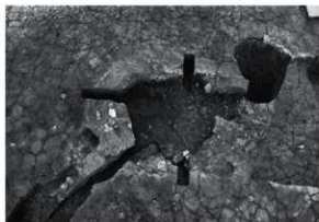
SL01 炉体内天井崩落状況 (北から)
