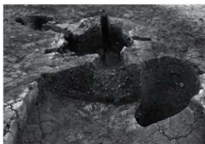
SL01 炉体内天井崩落状況 (西から)
