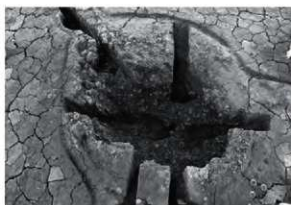
SL04 炉体内天井崩落状況 (東から)
