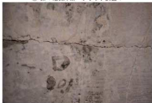
③ 第1砲側庫跡 クラック調査3
