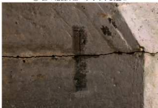
④ 第1砲側庫跡 クラック調査4
