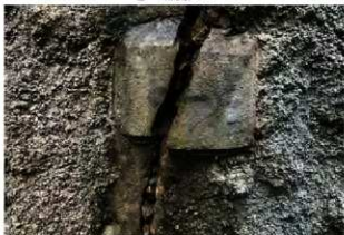
④ ドイツ壁表面のコンクリート（クラック調査）
