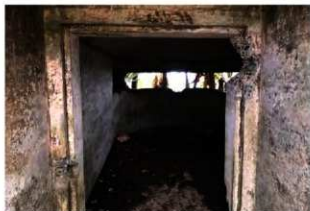
① 第1観測所跡入口の扉跡
