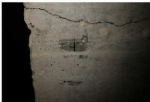
② 第1砲側庫跡 クラック調査2
