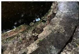
② 第2砲座跡砲座コンクリート剥離面
