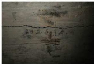
① 第1砲側庫跡 クラック調査1
