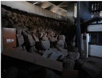
小天守穴蔵石垣崩落状況
