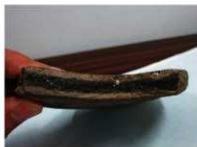
破断面の状況
