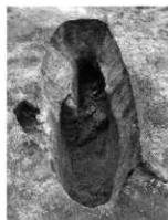
12. TP-175壁崩落状態 SW→
