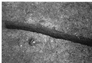
3. VF-01検出 SE→
