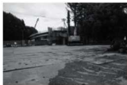
H. 北海道大学基幹・環境整備（跨道橋撤去等） 工事（北西より）調査番号：2123
