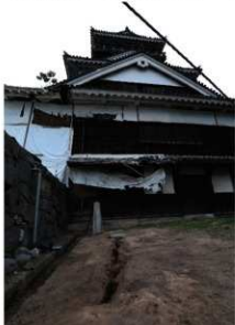
地表面で確認できる熊本地震の影響
