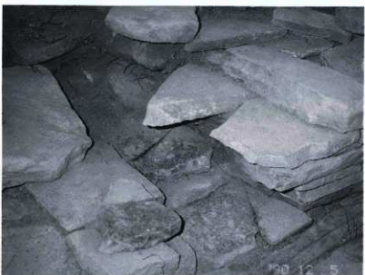
割れた基底部石材
