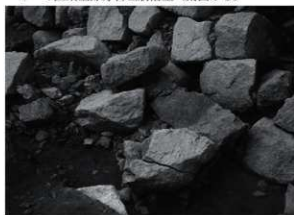
5 4区崩落石(南東から)
