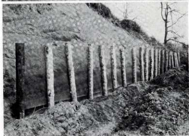
後円部南側崩壊崖面編織工 (同上)
