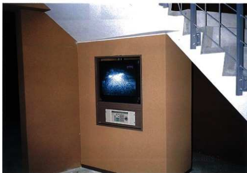
モニターテレビ設置状況
