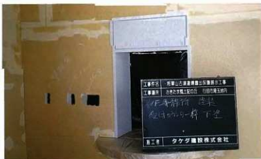
受付カウンター枠（1階事務所）
