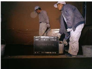
珪藻タキかき落し状況（2階）
