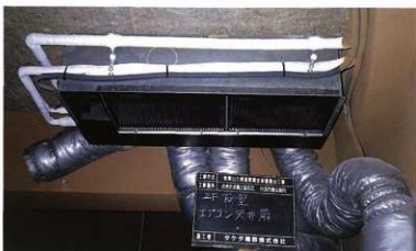
石室内エアコン設置状況
