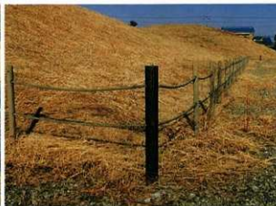
写真166 柵の現状（角の撥木は新設のもの）
