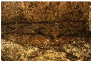
㊦8赤変状況断面
