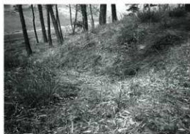
第61図版 二段目以下の道と崩落状況
