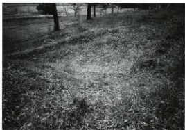
第67図版 くびれ部付近の崩落状況
