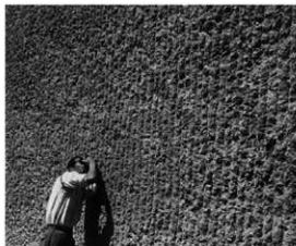
写真32 コンクリート壁のハツリ仕上げ （工学院大藤森研究所蔵）
