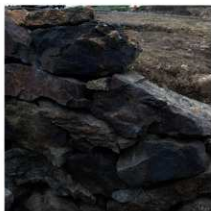
SX600石垣の火災痕跡
