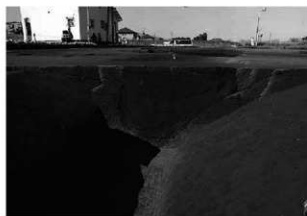
SZ06 土面断層 東より
