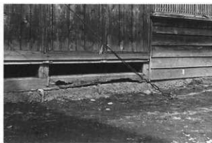
1 修理前 基礎と土台の破損・腐朽
