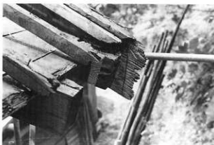
3 解体中 軒先妻部分の腐朽 証が残存した
