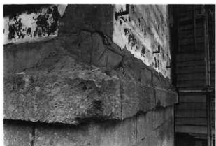
5 修理前 腰部土壁破損状況
