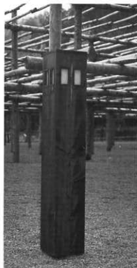
図79 照明灯設置状況
