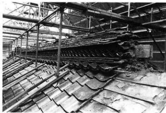
3 修理前 屋根・棟樑破損状況
