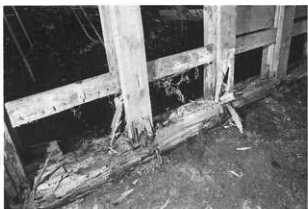
3 解体中 土台・柱根腐朽状況
