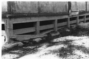
1 修理前 基礎、柱根廻り破損状況
