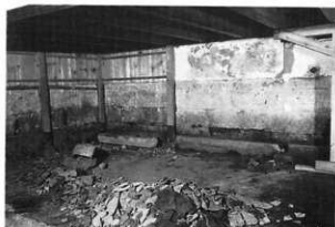
図15 文書倉 地階破損状況
