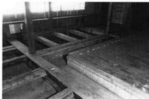
1 解体中 「漁夫溜場」床組 北西より見る 転用材が用いられている
