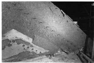
1 修理前 妻部土壁破損状況
