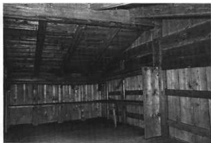
5 修理前内部 2階東端部
