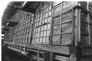
2 修理前 正面詳細
