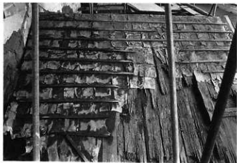
4 解体中 前室屋根土居葺破損状況
