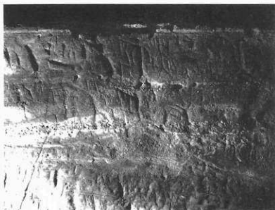
図3 線刻壁面表面に繁茂する緑色生物
