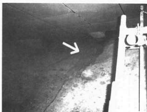
写真5 夏季に見られた漏水（平成15年9月）
