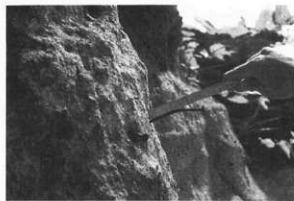
写真1 フゴッペ洞窟外壁に打ち込んだ釘 (侵食剥離測定用) 1971年9月6日撮影
