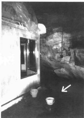
写真3 防水処理前に見られた漏水（平成10年3月）
