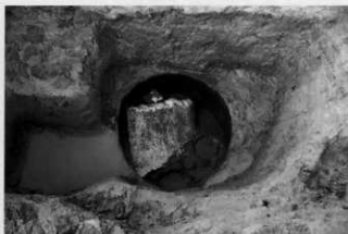
SE13 上位井戸枠落下状況 北から
