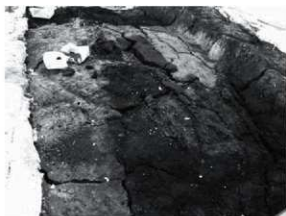
写真4 ヒビ発生（平成16年10月）
