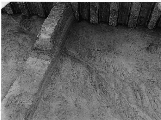
1 地滑り痕全景（海側から）
