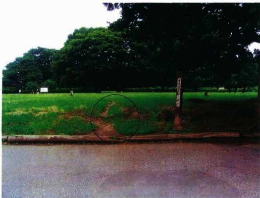
H 南側道路から見た金堂基壇。道路からの登口となってしまう箇所は、盛土が流れ、一部で遺構面が露出している。
