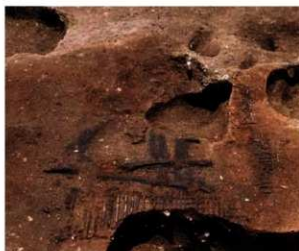
写真5 火災で焼失した町屋 五丁目 木舞（壁の下地に組んだ竹）が密封された状態で残っていた
