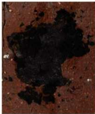
漆による補修跡（写真2の外側）
