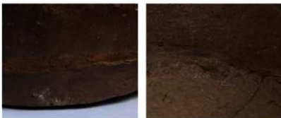
写真1の補修跡外面(左)と内面(右)
