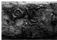
Fig.31 柄の劣化状態
