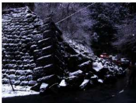
第8図 本丸北西石垣の崩落状況(1)
