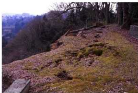
第12図 本丸東側崖面の被災状況
