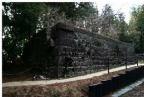
第11図 中門石垣の被災状況
