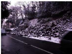
第9図 本丸北西石垣の崩落状況(2)
