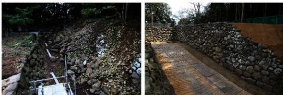
第 18 図 西門石垣の崩落状況(左)と復旧状況(右)
