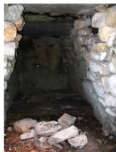
第6図 法領塚古墳の被災状況
