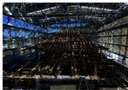
図 7 補助制度を活用し復旧が進む皆楽寺本堂
