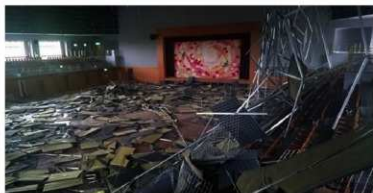
図 2 町有施設（総合体育館）の被害状況
