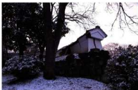
第 15 図 大手門北側土塀の被災状況 (2)
