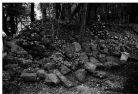
第10図 西門石垣の崩落状況
