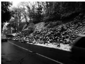
第9図 本丸北西石垣の崩落状況(2)
