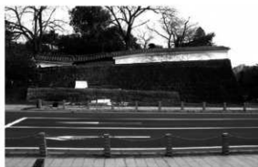
第14図 大手門北側土塀の被災状況(1)
