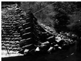
第8図 本丸北西石垣の崩落状況(1)
