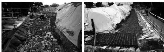
第20図 石垣裏込めの修復状況（左：伝統工法による施工、右：一部施工した現代工法）
