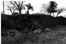
第13図 広瀬川護岸石垣の崩落状況(指定地外)
