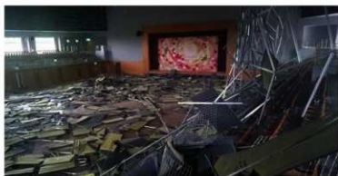
図 2 町有施設（総合体育館）の被害状況
