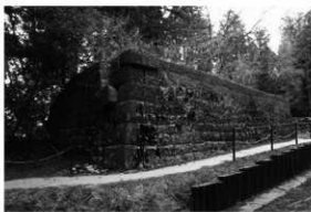
第11図 中門石垣の被災状況
