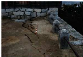
写真3 試掘 T2 調査前地割れ・地盤沈下状況 (北より)
