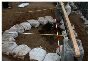
写真1 試掘 T1 調査前陥没状況 (北より)
