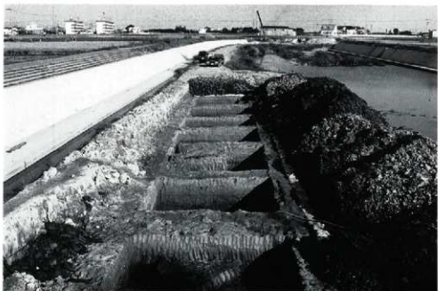
(上) 第Ⅰ次調査左岸側調査風景 (下) 第Ⅰ次調査左岸側完成掘状況
