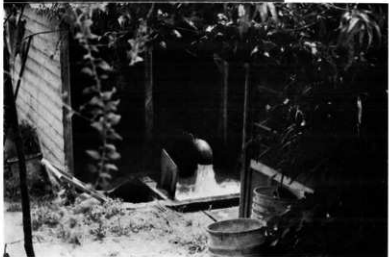
池島地区揚水ポンプ
