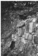
⑬ 通水口があつたが崩れている
