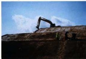
6 後方部造成状況
