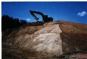
5 後方部造成状況
