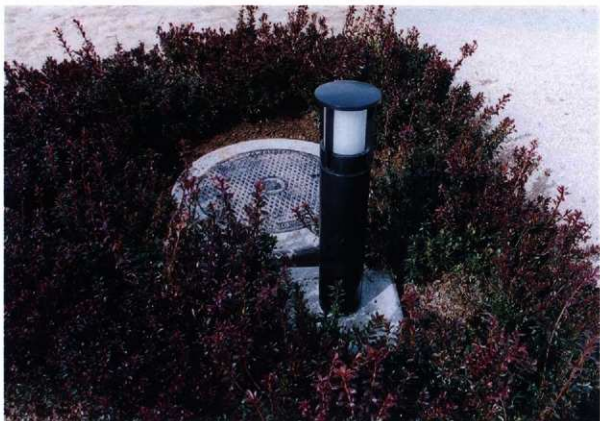
2 照明施設 (フットライト)
