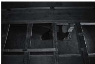
写真 174 諸役会所床下陥没箇所（東から）
