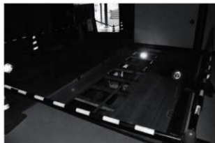
写真 173 諸役会所床下陥没箇所（東から）
