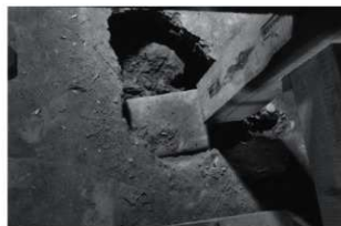
写真 175 諸役会所床下陥没状況（北から）
