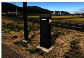
図 8-2-19 電源設備 (吉武高木遺跡 / 福岡市)
