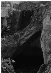
倒れた西側壁部分 (南より)
