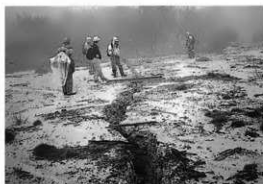
小串鉾山跡 地割れ
