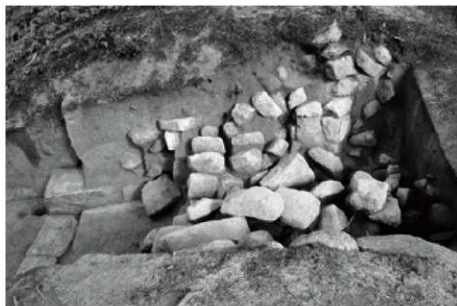
2. 側壁石材の崩落状況
