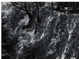
図60 石垣No.308から生える樹木
