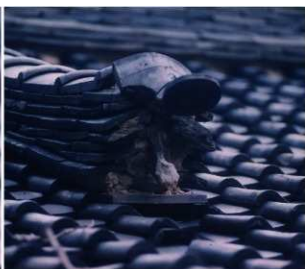
北東部降り棟先端の鬼瓦欠失部
