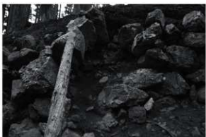
図25 補修箇所2（補修前）（西から）
