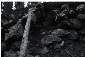
図25 補修箇所2（補修前）（西から）
