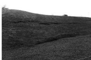
2. 令和元年台風19号の被害状況（南東から）
