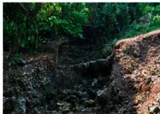
写真11 岸の石積と河床のはつり (?)
