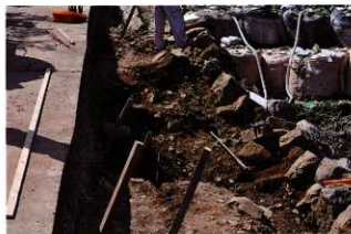
⑥崩壊部裏込め土層断面 (北から)
