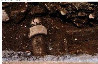
⑦崩壊部裏込めに入るヒューム管・U字溝 (北から)
