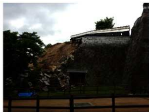
奉行丸 H9 面 石垣・崩落状況（東から）
