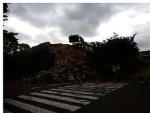
奉行丸南東隅石垣崩落状況（南東から）
