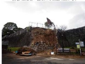
奉行丸南東隅崩落石材回収後（南東から）
