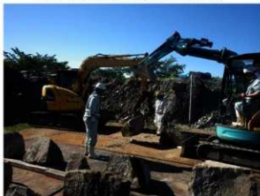
崩落石材回収状況
