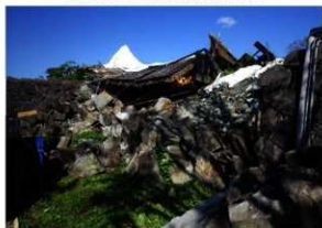
奉行丸 H33・34 被災状況(南東から)
