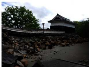
西大手 H42 被災状況 (北東から)
