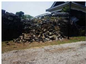
西出丸 H81 被災状況 (東から)
