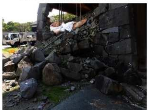
西大手門 40 被災状況 (北西から)
