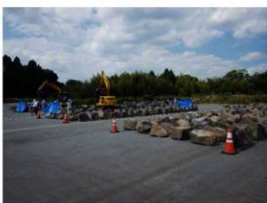
崩落石材管理状況
