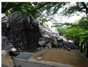
西大手門 H3 被災状況(北から)
