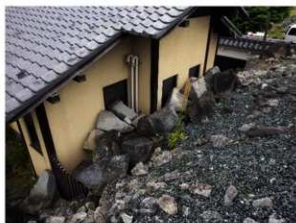
H39 トイレ裏被災状況 (北西から)
