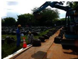
崩落石材記録状況
