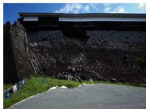
数寄屋丸 H323 (西側) 被災状況 (南から)
