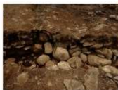
地割れ部分壁面 (西から)
