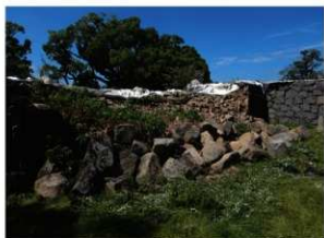
回収前崩落状況
