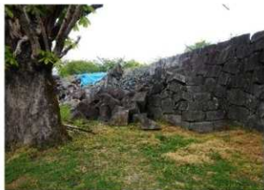
奉行丸 H34・35 被災状況(南東から)
