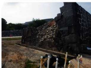
西大手門 40 被災状況 (北西から)
