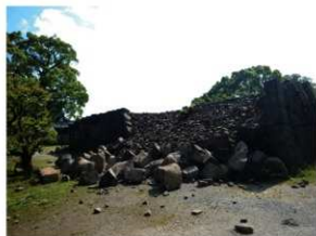
飯田丸 H258 被災状況 (北東から)
