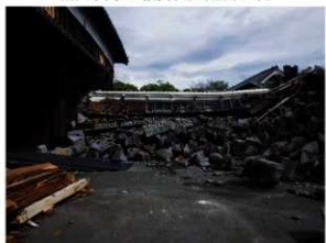
西大手門 H41 被災状況 (西から)
