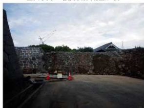
西大手門 H41 被災状況 (西から)
