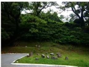
数寄屋丸 H308 崩落石材（西から）
