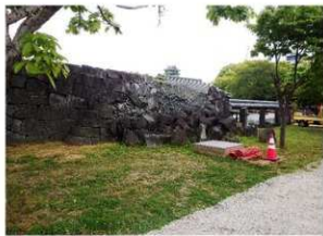
奉行丸 H38 被災状況(南西から)
