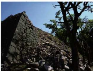
N34石材崩落状況 北西から
