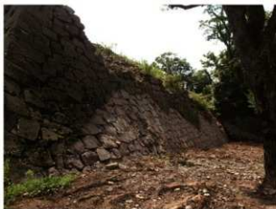
N34崩落石材回収後状況 北西から
