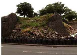
N50石材崩落状況 北から
