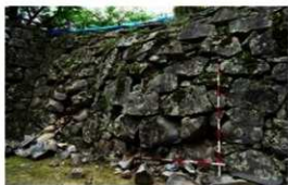
写真-1 孕み出しの様子 1)
