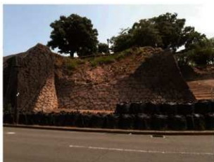
N50崩落石材回収後状況 北から
