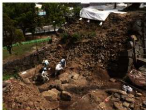
不開門虎口崩落グリス回収状況 南から
