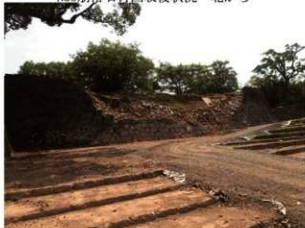
N48崩落石材回収後状況 北から
