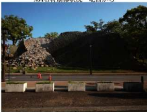
N35石材崩落状況 北から
