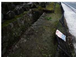
毀損確認 南から
