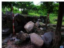
写真10 被災石垣拡大③(南東より)
