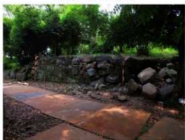
写真7 被災石垣全景(東より)
