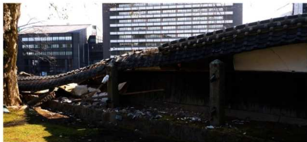
重要文化財長堀被災状況
