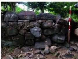
写真9 被災石垣拡大②(南東より)
