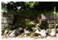
P1 地震による石積崩落部分 南から
