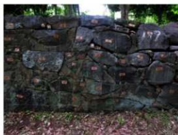
写真8 被災石垣拡大①(南東より)
